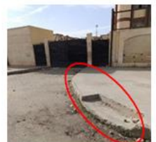
شكل 81 عدم وجود منحدرات للأرصفة
