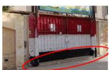
شكل 85 عدم وجود منحدرات للمدخل الرئيسي (تصوير الباحثة)
