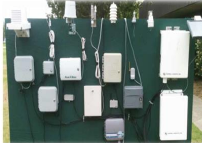
شكل (2) يوضح وحدات التحكم الذكية بضبط دورات الري باستخدام بيانات من أجهزة استشعار الأرض والطقس. والمربعات المستطيلة هي وحدات برمجة وحدة التحكم، والقطع المثبتة على الجزء العلوي من اللوحة الخضراء هي أجهزة استشعار الطقس. [4]
